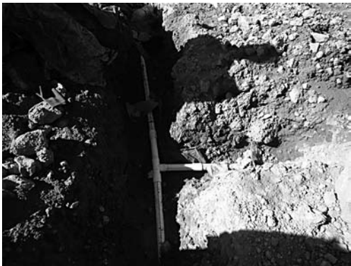
途中で破裂している水道管
