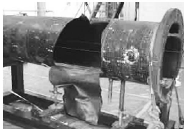
復水配管破損部（関西電力事故報告資料より）
